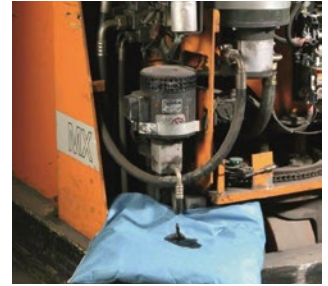
Pod ciekące urządzenie
