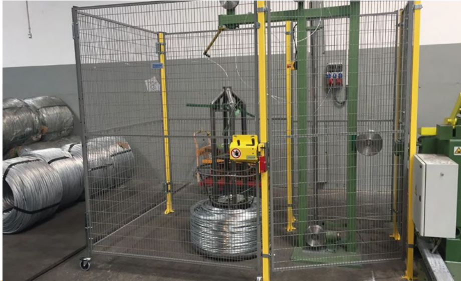
WYGRODZENIA MASZYN I CIĄGÓW KOMUNIKACYJNYCH ZAPEWNIĄJĄCE BEZPIECZEŃSTWO PRACOWNIKÓW
